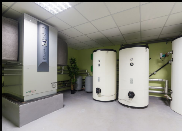
Vnitřní instalace vzduch/voda - LW 251
